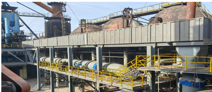
煤粉预热系统现场
